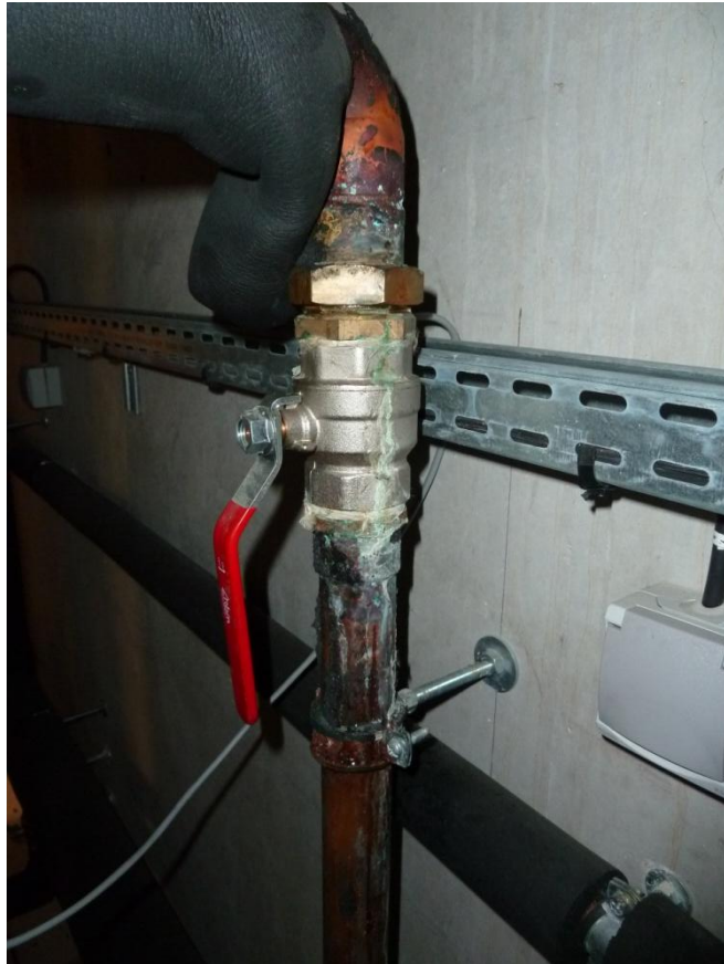
Illustration d'un raccord non étanche à l'air (micro-fuite avec apparition de vert de gris)
