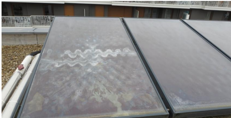
Absorbeurs des capteurs solaires fortement dégradés
