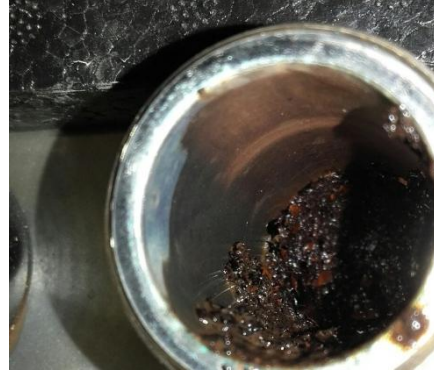
Circuits solaires obstrués
